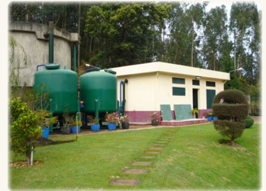
Estação de Tratamento de Água de São Jorge Capacidade de tratamento - 1.728 m 3 /dia
