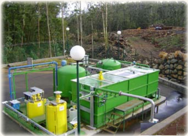
Estação Elevatória da ETA do Santo da Serra
