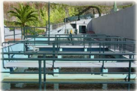
Estação de Tratamento de Água do Covão Câmara de Lobos
