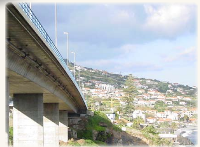
Conduta “da Cota 200”
