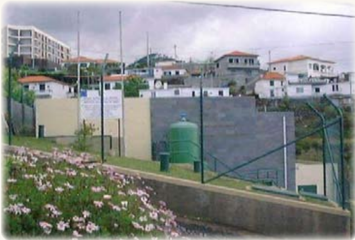
Reservatório do Livramento (Santa Cruz) Volume - 500 m 3
